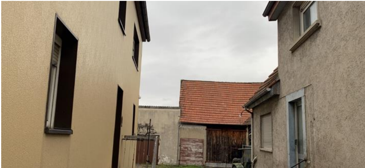
Abb. 7: Mindergenutzte bzw. Sanierungsbedürftige Nebengebäude (Foto: bhm)
